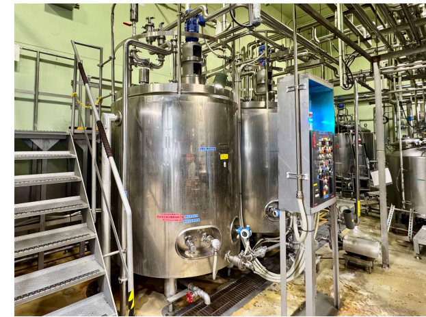
1.5 t 調合タンク 洗浄死角になりやすいタンク内10ヶ所の拭き取り検査を実施
